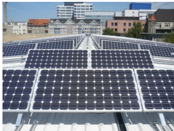
Die Photovoltaikanlage auf der Friedensburg-Oberschule im Berliner Bezirk Charlottenburg-Wilmersdorf mit 65 Kilowatt Leistung. Beide Fotos © 30°-SOLAR GmbH
